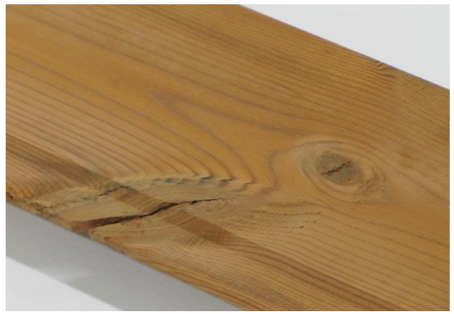
Dopuszczalne są pojedyncze pęknięcia sęków.
